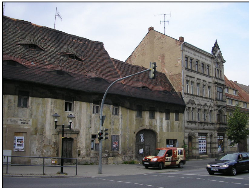
Abb. 9: Sanierungsbedürftige, unattraktive Gebäudereihe am südlichen Ende der Breiten Straße in Pirna 50
